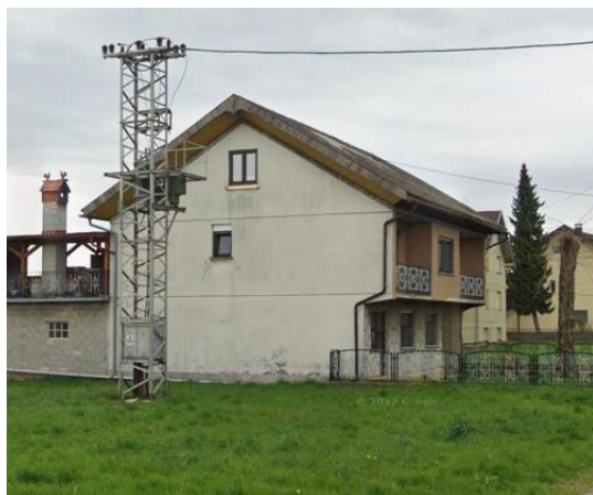
Slika 10. Trafostanica Hudi Bitek u Brezovičkoj ulici
